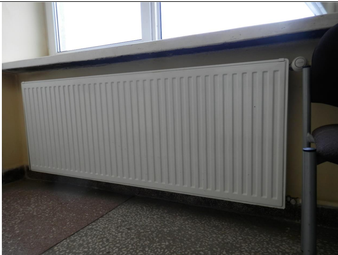
Grzejnik stalowy płytowy w systemie grzewczym budynku.
