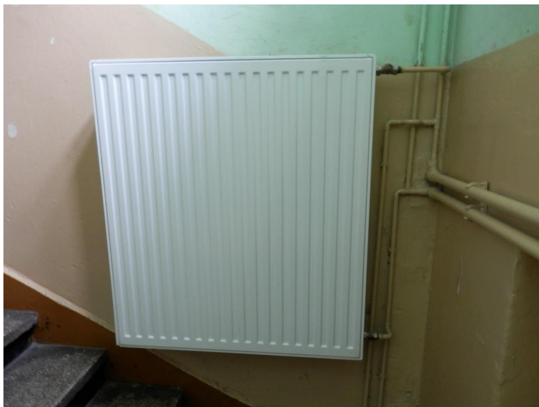
Grzejnik stalowy płytowy w systemie grzewczym budynku.
