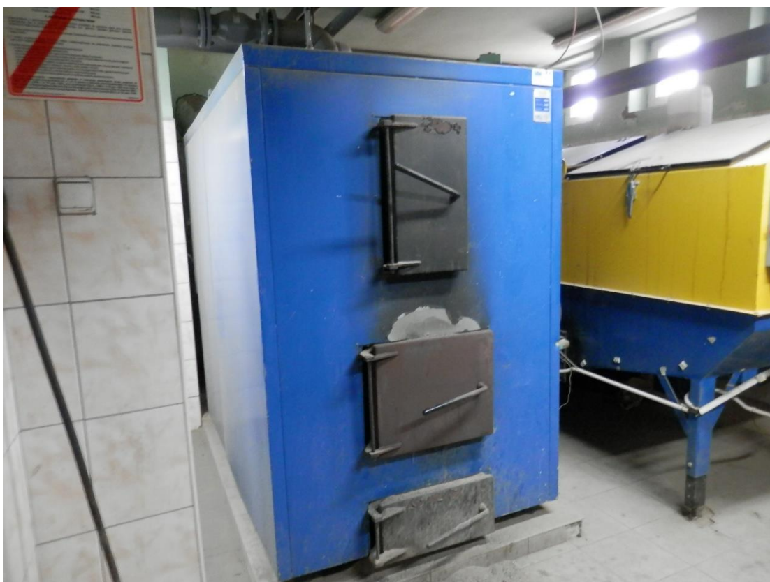
Źródło ciepła dwa kotły typ KKF Faleńczyk o mocy 200,0 kW każdy, opalane biomasa.
