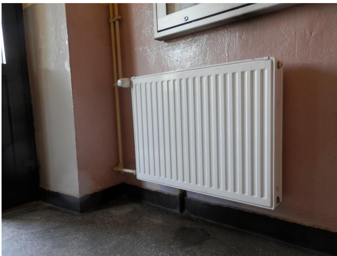
Grzejnik stalowy płytowy w systemie grzewczym budynku.
