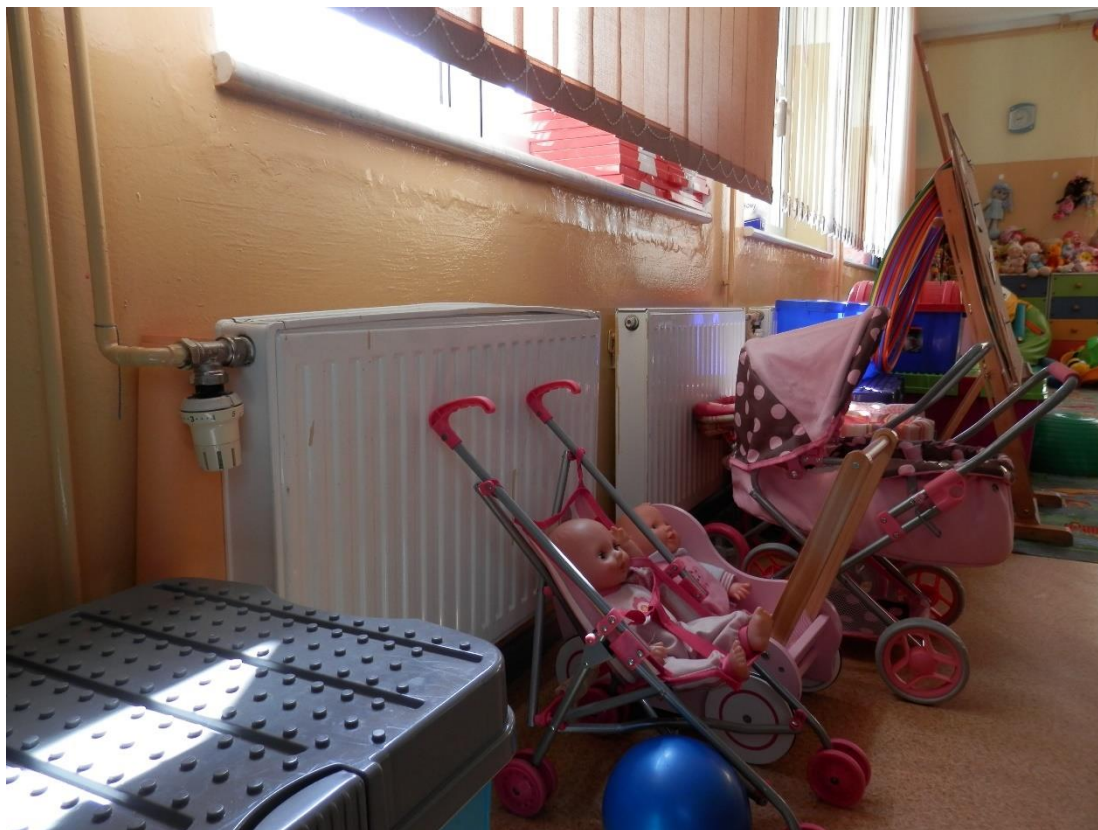
Grzejniki stalowe płytowe w systemie grzewczym budynku.
