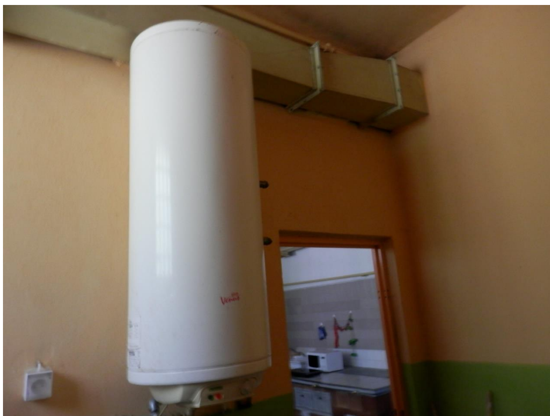
Elektryczny akumulacyjny ogrzewacz wody zamontowany na poziomie piwnicy budynku.
