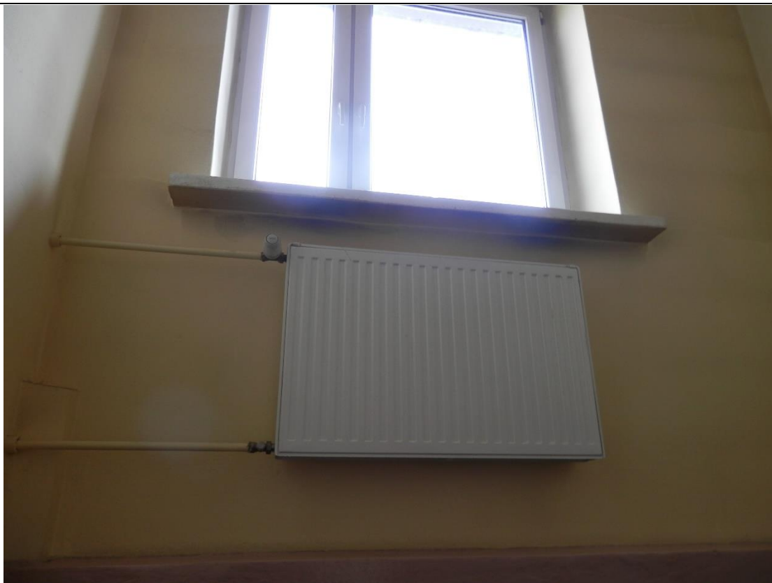
Grzejnik stalowy płytowy w systemie grzewczym budynku.
