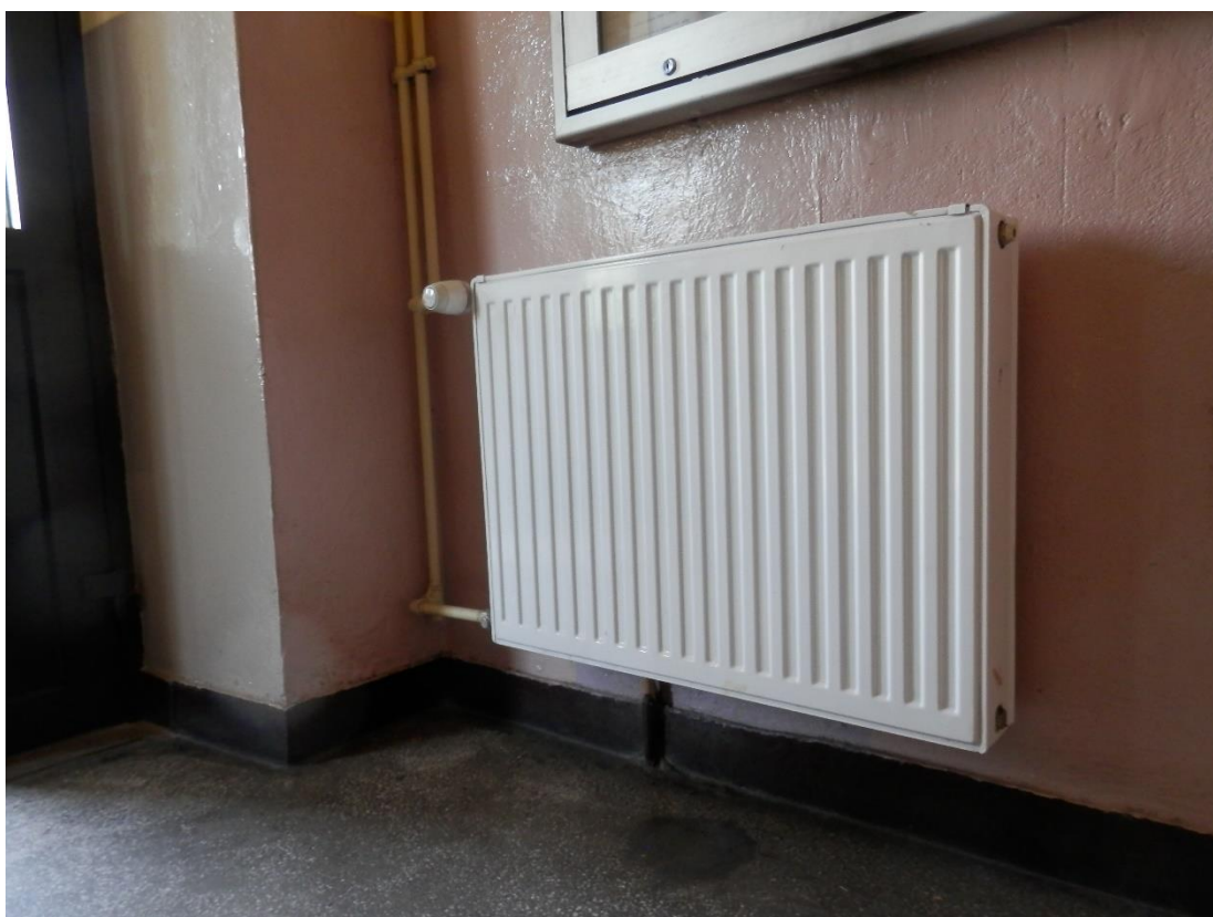
Grzejnik stalowy płytowy w systemie grzewczym budynku.
