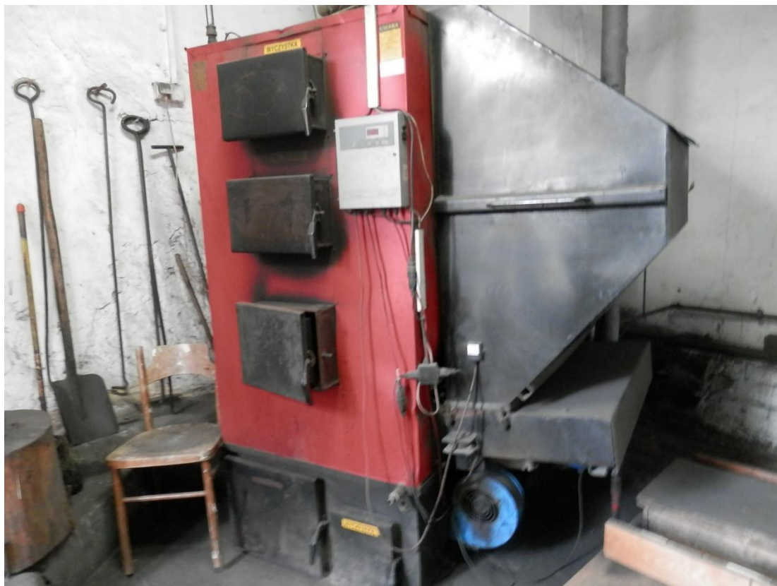
Źródło ciepła - kocioł o mocy 150,0 kW opalany węglem kamiennym.
