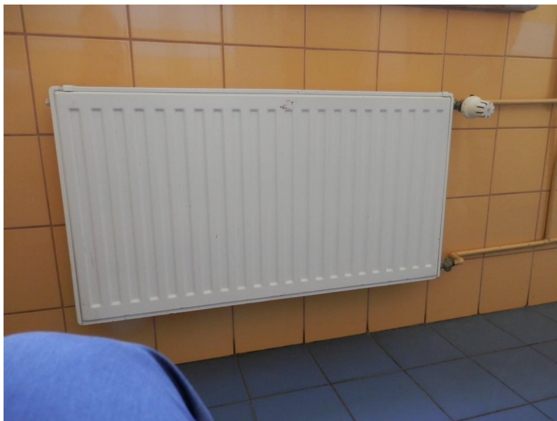
Grzejnik stalowy płytowy w systemie grzewczym budynku.
