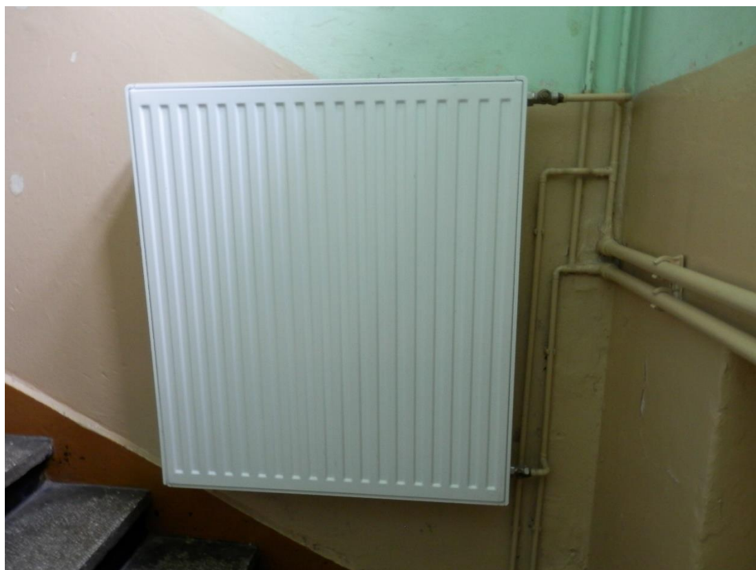
Grzejnik stalowy płytowy w systemie grzewczym budynku.
