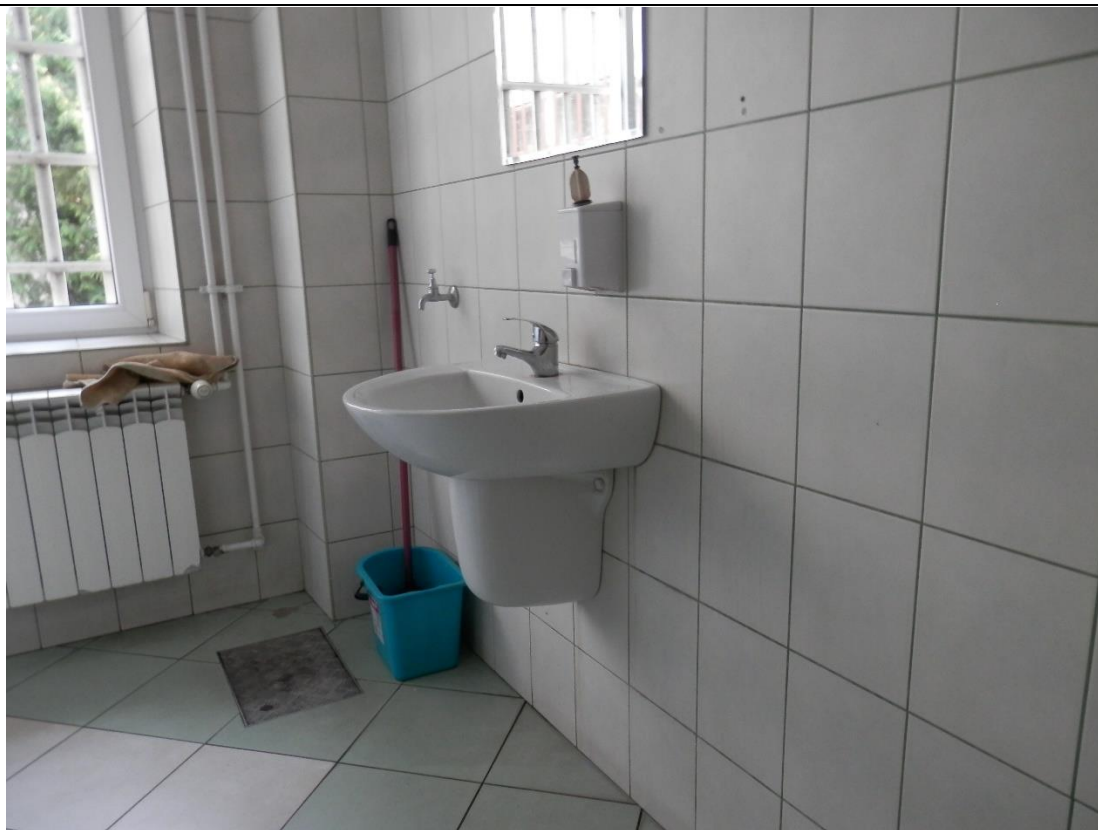
Punkt poboru wody w pomieszczeniu sanitarnym.
