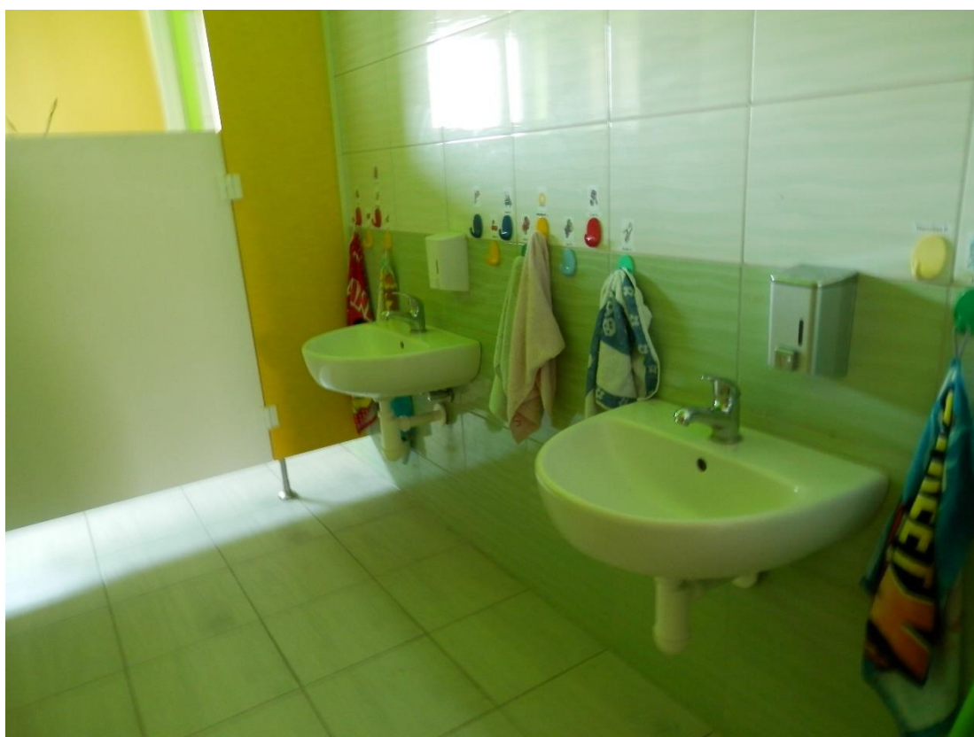
Punkty poboru zamontowane w pomieszczeniu sanitarnym.
