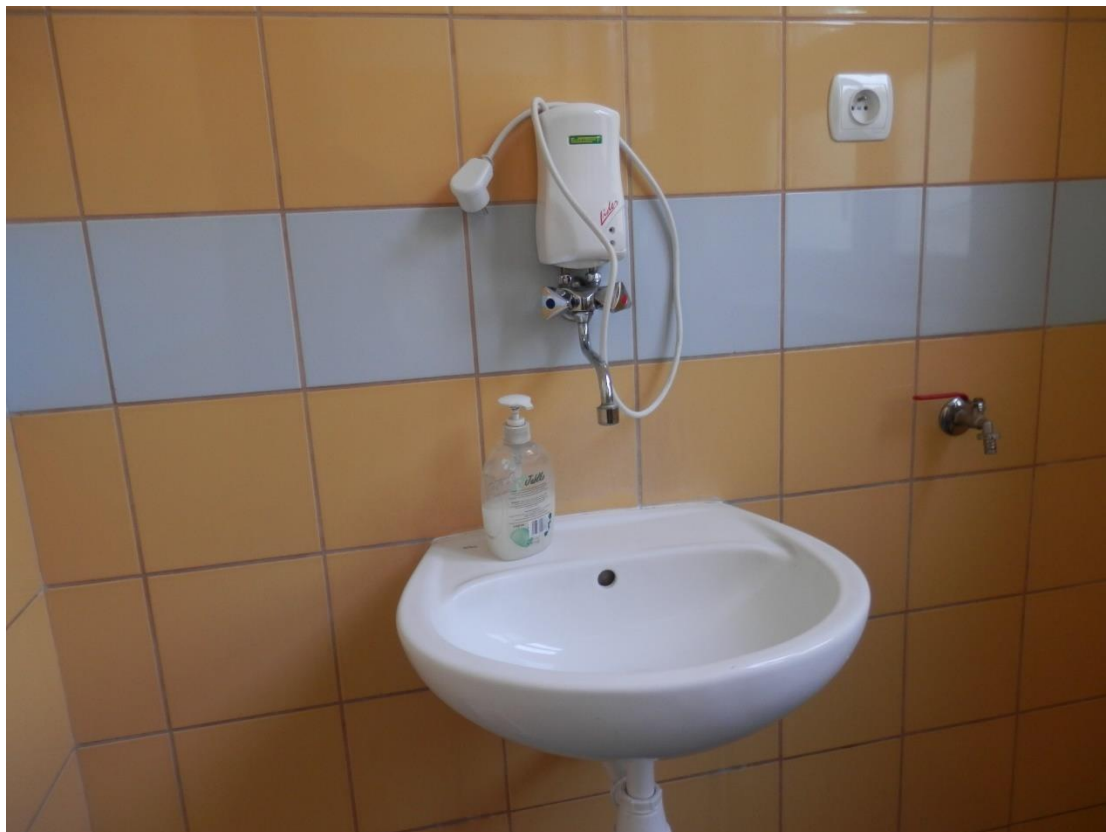
Elektryczny przepływowy podgrzewacz c.w.u. nad punktem poboru w pomieszczeniu sanitarnym na poziomie parteru budynku.
